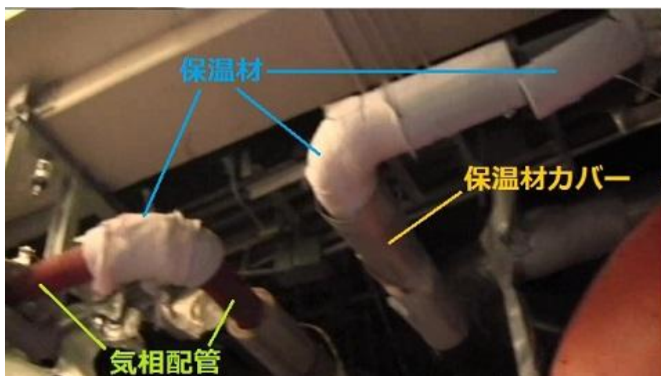
写真2：非常用復水器南側気相配管の保温材脱落状況（甲A148 5分48秒頃）
