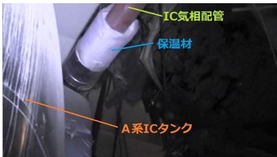
写真11 : 非常用復水器北側の保温材脱落状況 (甲A148 9分8秒頃)
