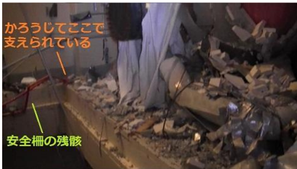
写真4：4階大物搬入口北側安全柵が失われた状況（甲A148 11分53秒頃）
