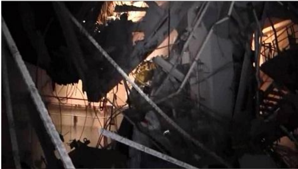
写真9：原子炉建屋4階北側天井の破損開口部の状況（甲A148 3分37秒頃）
