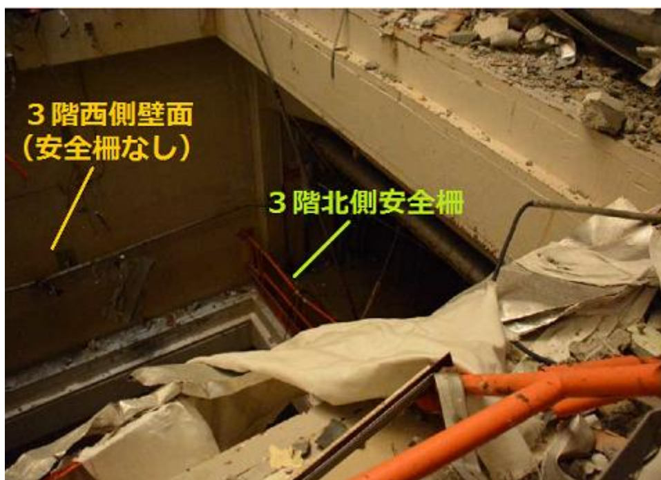
写真6：3階大物搬入口西側及び北側の状況（甲A149「1号機4階における出水事象に関する現地調査結果について 11 」25頁）
